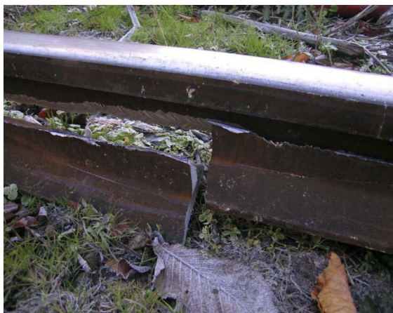
Figur 1: Viser skade på skinnegang.
