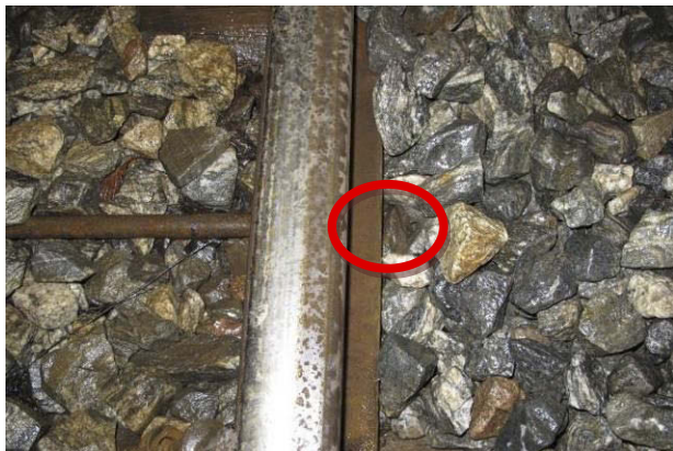
Figur 7: Bilde av ødelagt strekkbolt i Brynsbakken, festet til skinnefoten mangler.
