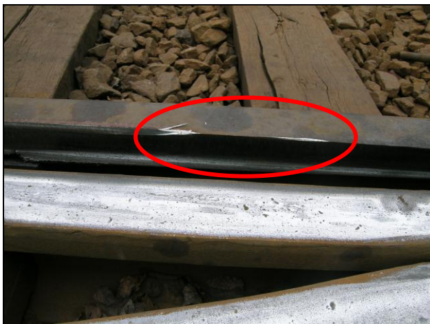
Figur 3: Viser avspøringsmerket i sporveksel 3 hvor den første boggien i vogn 1 gikk av sporet.
