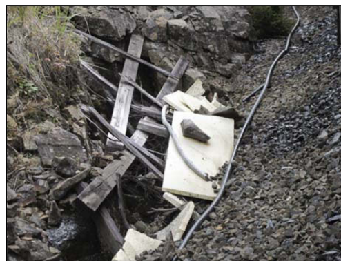
Figur 15: viser hull ved siden av sporet.
