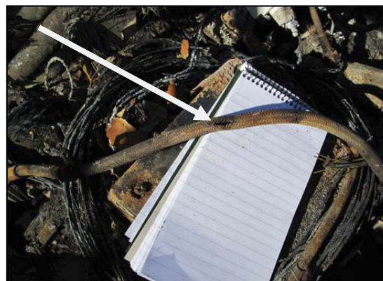
Figur 10: Oljeslange med kontaktskade i stålstrømpe slik den fremsto på toget.
