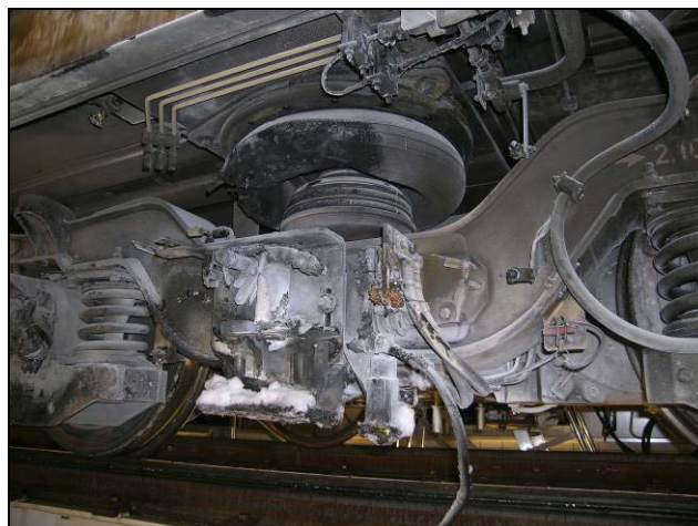
Figur 6: Viser skader som oppstod på strømvaktager som brant ved Holmen stasjon, januar 2010.
