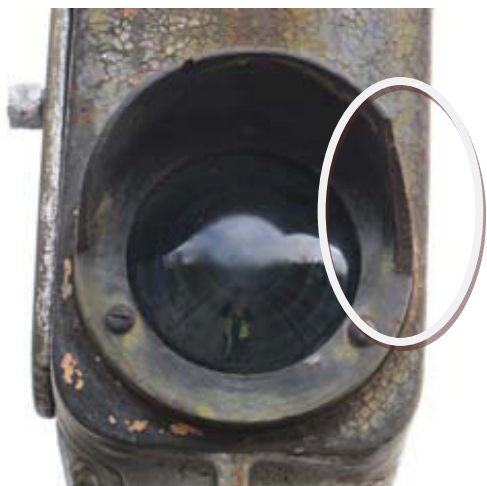
Figur 5: Viser defekt skyggeskjerm for det nedre grønne lyset i togsporsignal 1M.
