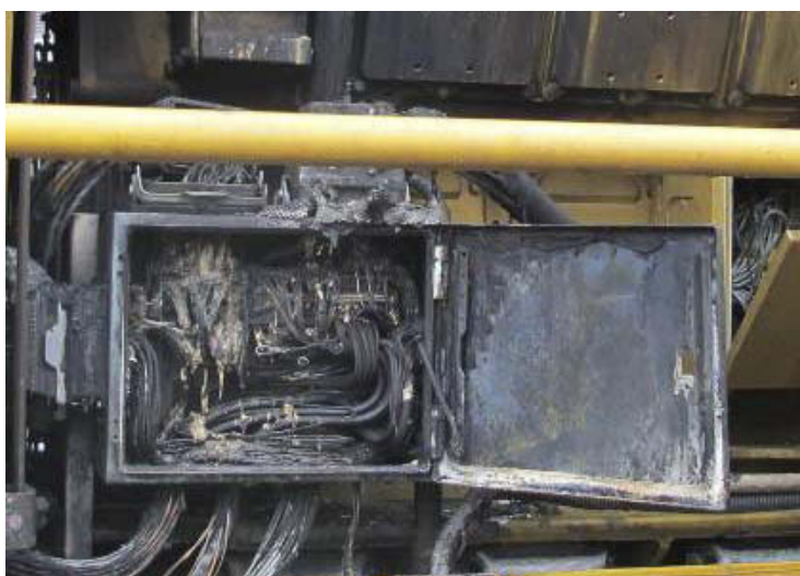
Figur 7: Elektrisk skap nederst som bl.a. overvåker temperaturen i motoren.
