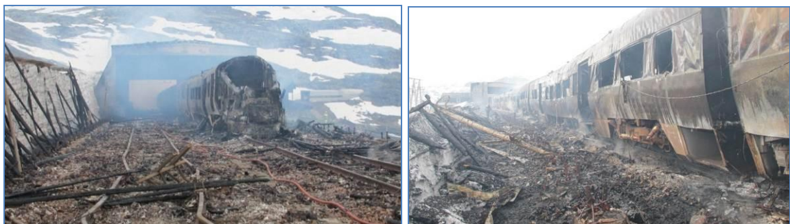
Figur 2 og 3: Bilder av skadene (kilde: SHT)
