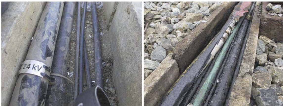
Figur 34 og 35: 24 kV kabel i kabelkanal sammen med tele- og signalkabler ved Hallingskeid. (Kilde: Jernbaneverket)
