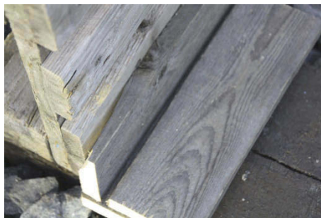
Figur 5-4 Spalte (av planker fra Hallingskeid).
