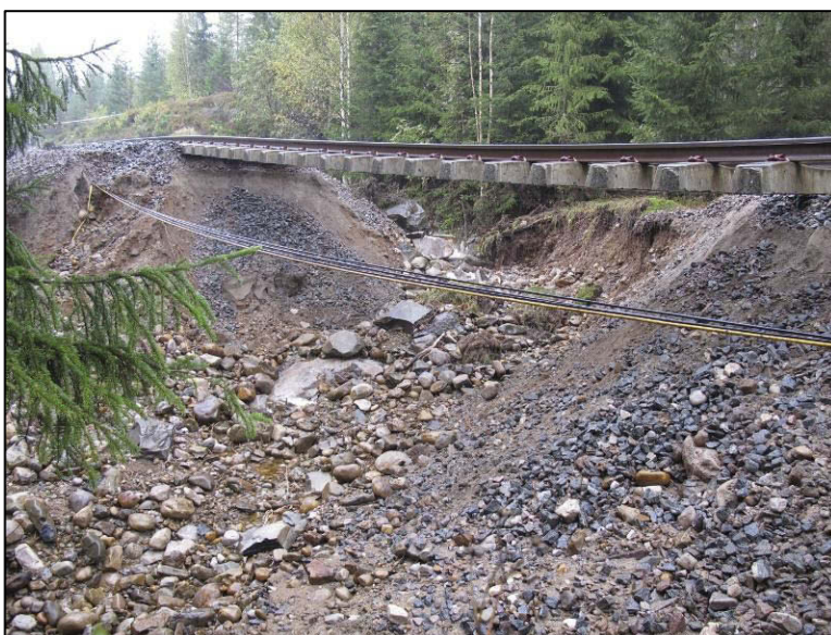
Figur 6: Viser det utvaskede område av infrastrukturen.
