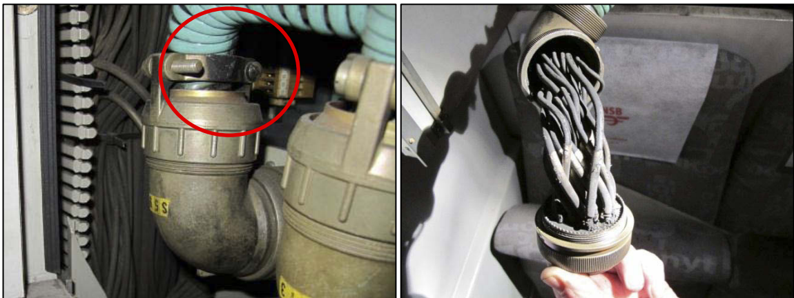
Figur 3: Sot på stikker og brannskadde kabler i S3. (Kilde: SHT)
