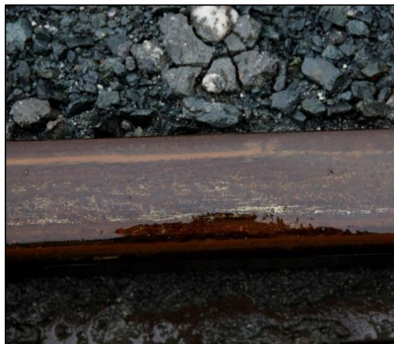
Figur 8: Fuktig skinne i spor 23. Foto: Politiet
