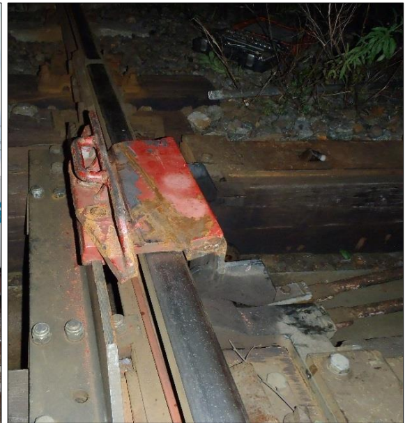
Figur 3: Oppkjørt sporsperre i spor inn mot Alnabru. Foto: SHT
