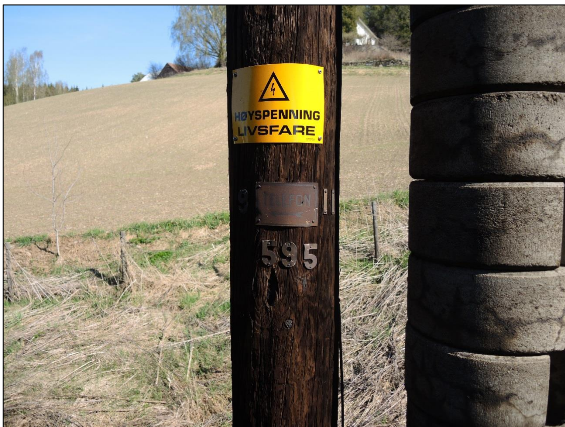
Figur 7: Mast for kontaktledningsanlegg med skilt. Foto: SHT
