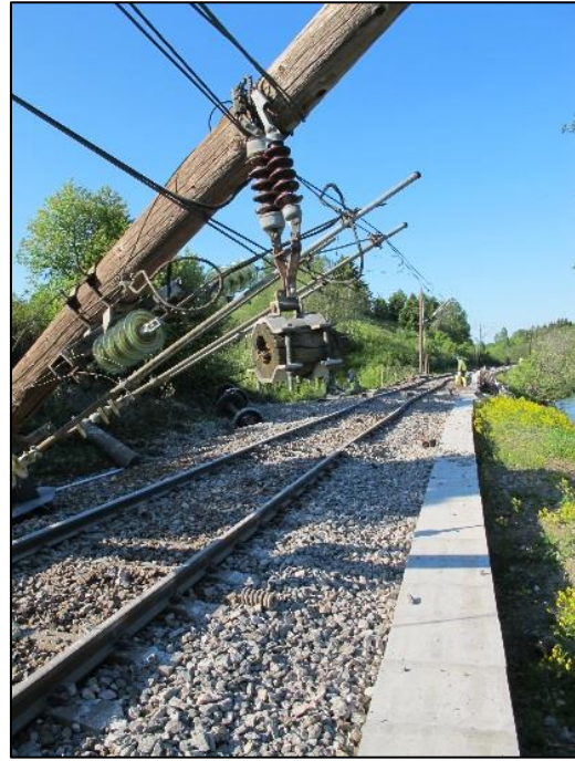
Figur 7: Skadet KL mast. Foto: SHT
