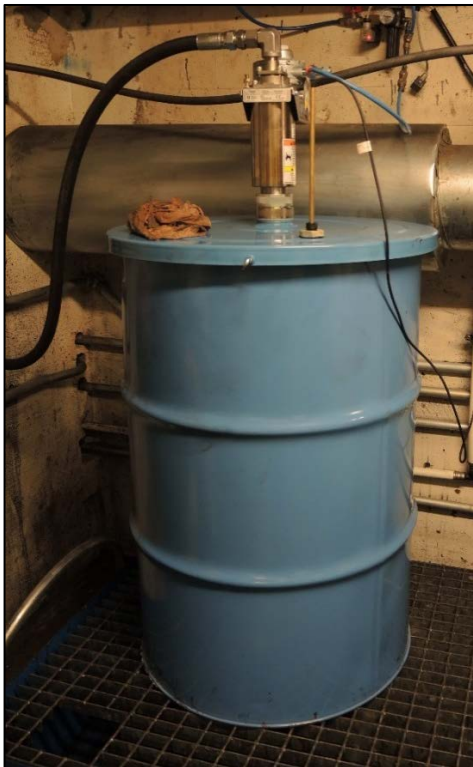
Figur 7: Sentralanlegg for påfylling av flensefett på Ryen verksted. Foto: SHT
