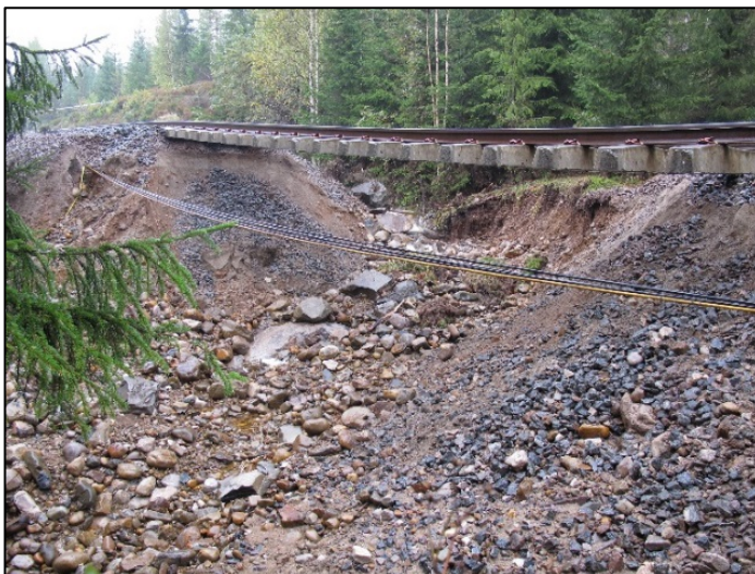
Figur 9: Utvasket spor ved Opphus, Rørosbanen. Foto: SHT
