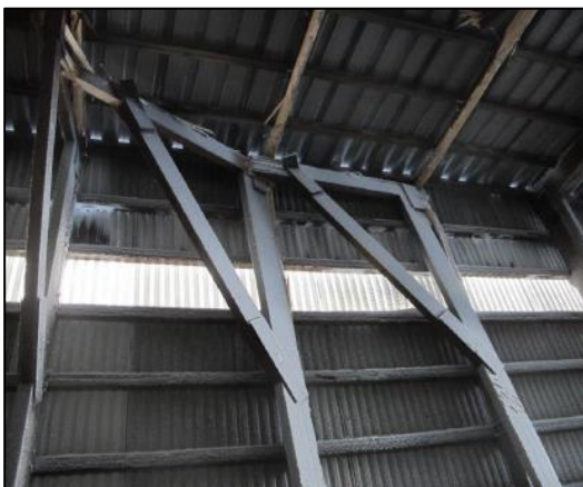
Figur 7: Ramme slått ut av posisjon. Foto: Bane NOR
