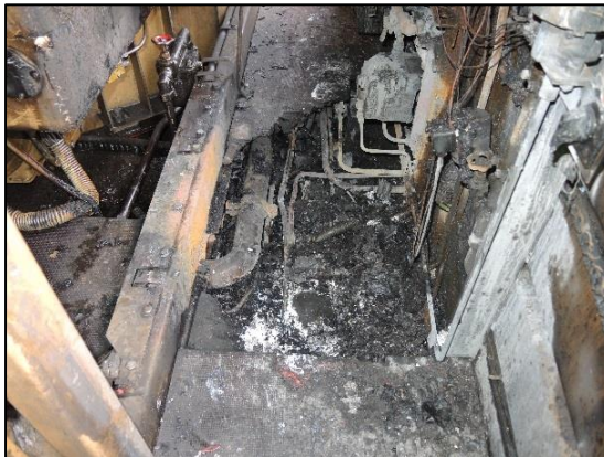
Figur 5: Brannskada golv inne i maskinrommet. Foto: SHT
