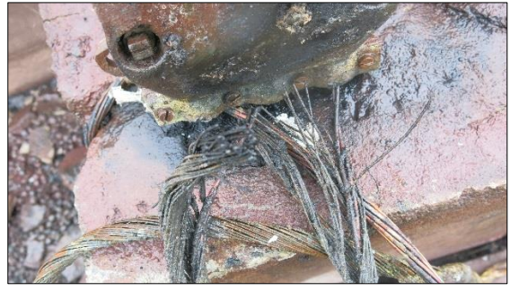
Figur 34: Kabler tilhørende signalanlegg. Foto: SHT
