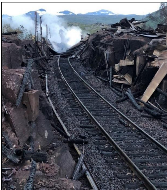
Figur 13: Skader etter brannen. Foto: Bane NOR SF
