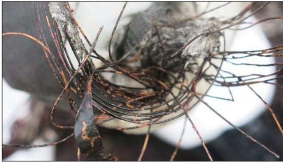
Figur 33: Kabler tilhørende signalanlegg. Foto: SHT
