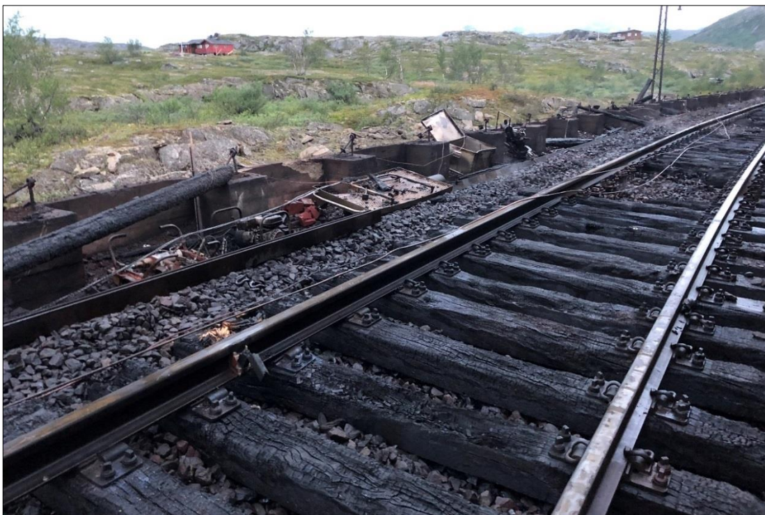
Figur 28: Siste sveis ved ca. km 39,253. Nedbrenning i sviller på hver side av sveiseområdet og utstyr til varme arbeider. Foto: Bane NOR SF
