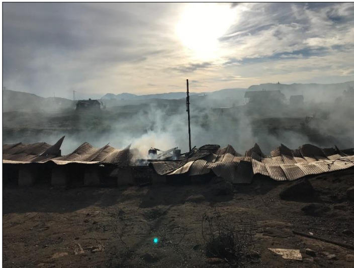
Figur 21: Kollapset snøoverbygg kl. 1906, 8. august 2018. Foto: Bane NOR SF
