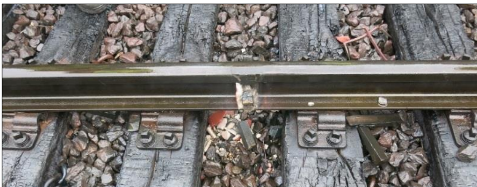
Figur 29: Grovslipt sveis ved km 39,403. Foto: SHT
