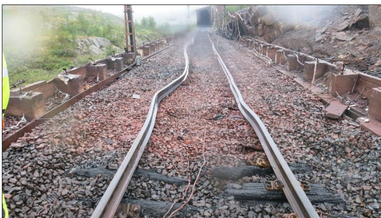
Figur 26: Brudd på KL mellom mast 2 og 3 ved km 39,179-208. Foto: SHT
