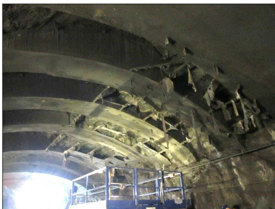
Figur 4: Skade i tunneltaket hvor det brant. Foto: SHT
