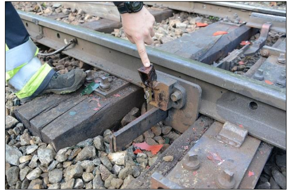
Figur 13: Kontrollås for sporveksel 1. Foto: SHT
