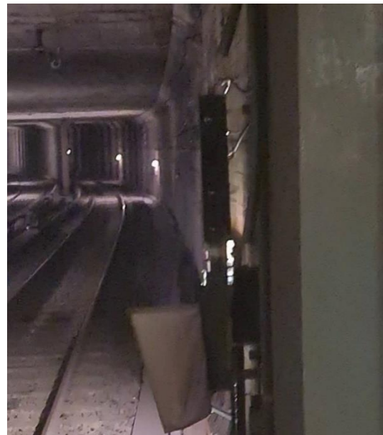
Figur 28: Signal T155 er mørkt. Foto: Sporveien AS
