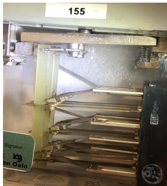
Figur 21: Høyre side sett forfra. Foto: SHK
