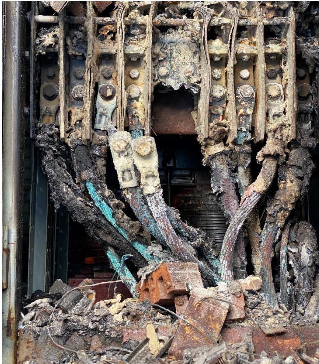
Figur 27: Avbrente koblinger S8-skap. Foto: SHK
