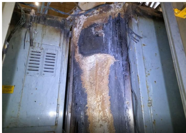
Figur 22: Utvendig skap i maskinrom. Foto: SHK
