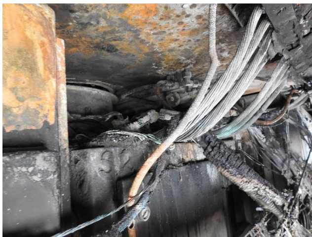
Figur 19: Brente kabler ved ventilasjonssjakt. Foto: SHK
