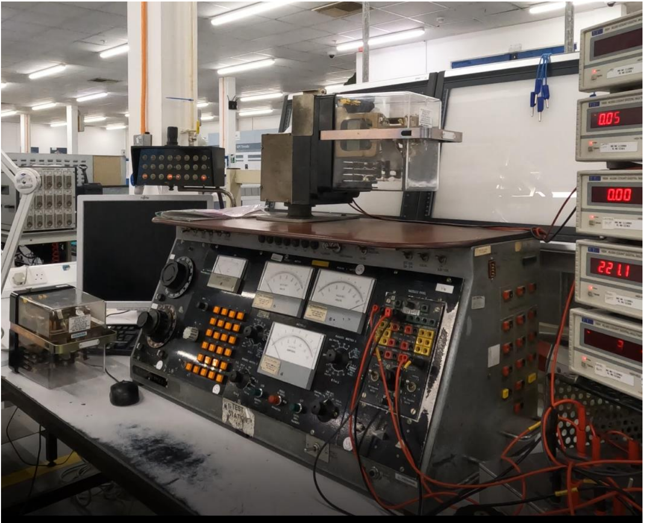
Figur 4: Sammenlikningsrelé montert oppe på testbenk. Det aktuelle reléet står på benken til venstre. Foto: SHK
