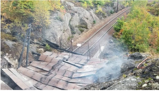
Figur 14: Takplater sett ovanfra. Foto: Østre Agder Brannvesen
