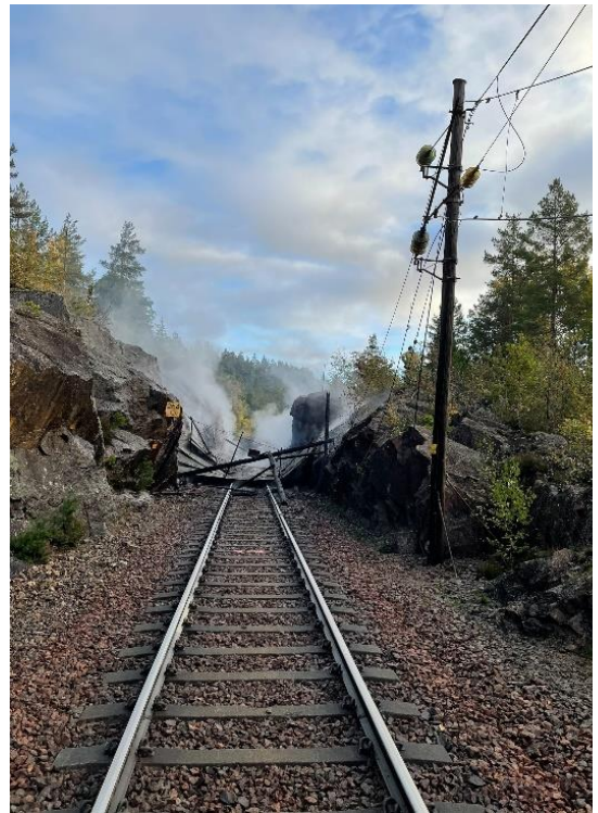
Figur 4: Det nedbrende snøoverbygget, vestre enden. Foto: Bane NOR SF
