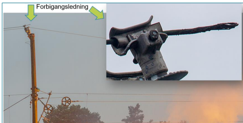
Figur 8: Brudd i forbigangsledningen til Sandefjord stasjon 27. juli 2021. Foto: Hans Morten Tamnes
