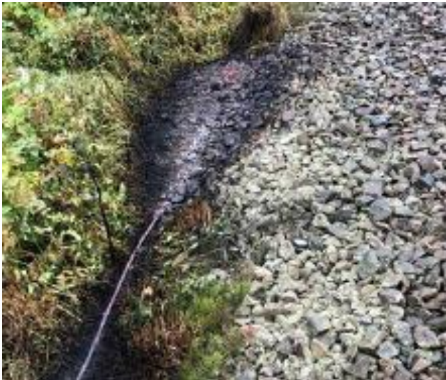
Figur 4: Kabel på Sandefjord stasjon. Foto: Bane NOR SF
