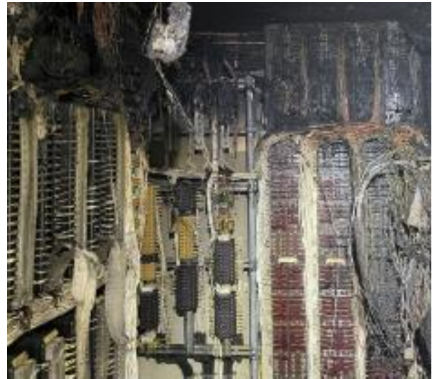
Figur 5: Relérom på Sandefjord stasjon. Foto: Bane NOR SF
