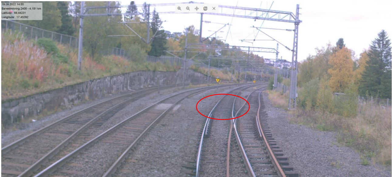
Figur 25: Målevognsbilde fra sporveksel 4 på Narvik stasjon. Foto: Bane NOR SF. Markering: SHK
