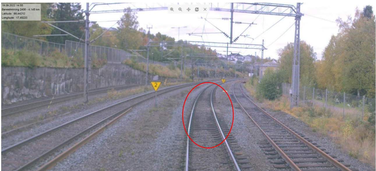
Figur 26: Målevognsbilde etter sporveksel 4 på Narvik stasjon. Bildet viser finnmasser og vegetasjon i ballast. Foto: Bane NOR SF. Markering: SHK
