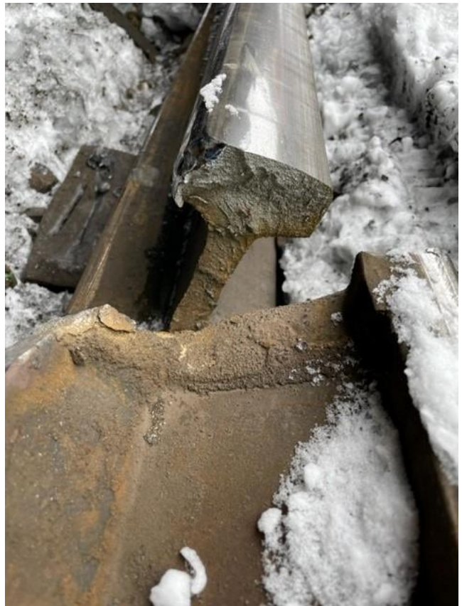
Figur 16: Første skinnebrudd i togets fartsretning. Foto: Bane NOR SF
