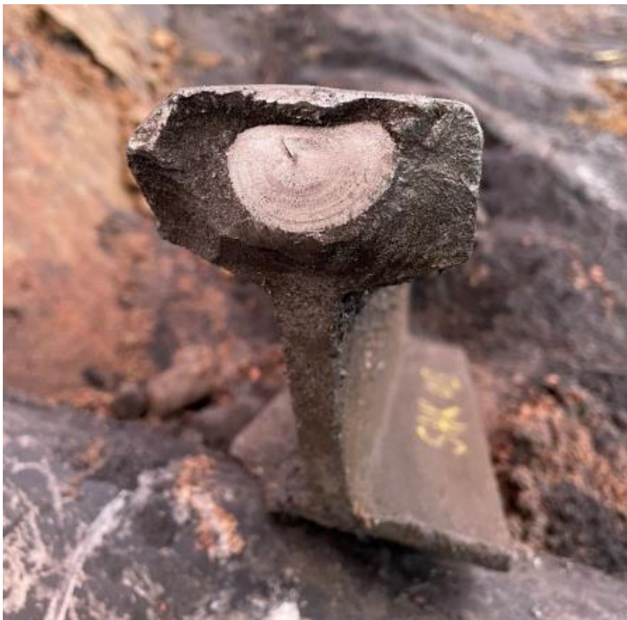
Figur 34: Sprekk i skinnehodet ved Linaälv. Foto: Statens havarikommisjon
