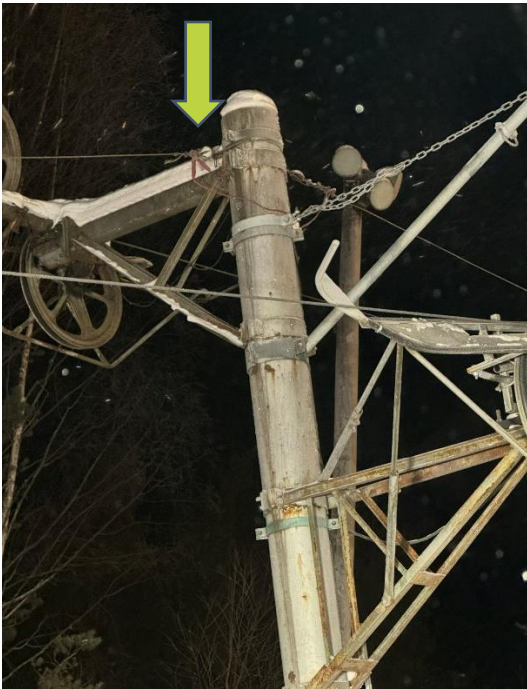
Figur 16: Forbikoblet avspøringsbryter i mast 2. Foto: SHK
