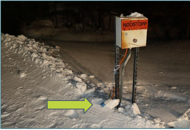
Figur 14: Nødstopppknappen og tilkoblingspunktet for nødstoppsnoren. Foto og påtegning: SHK
