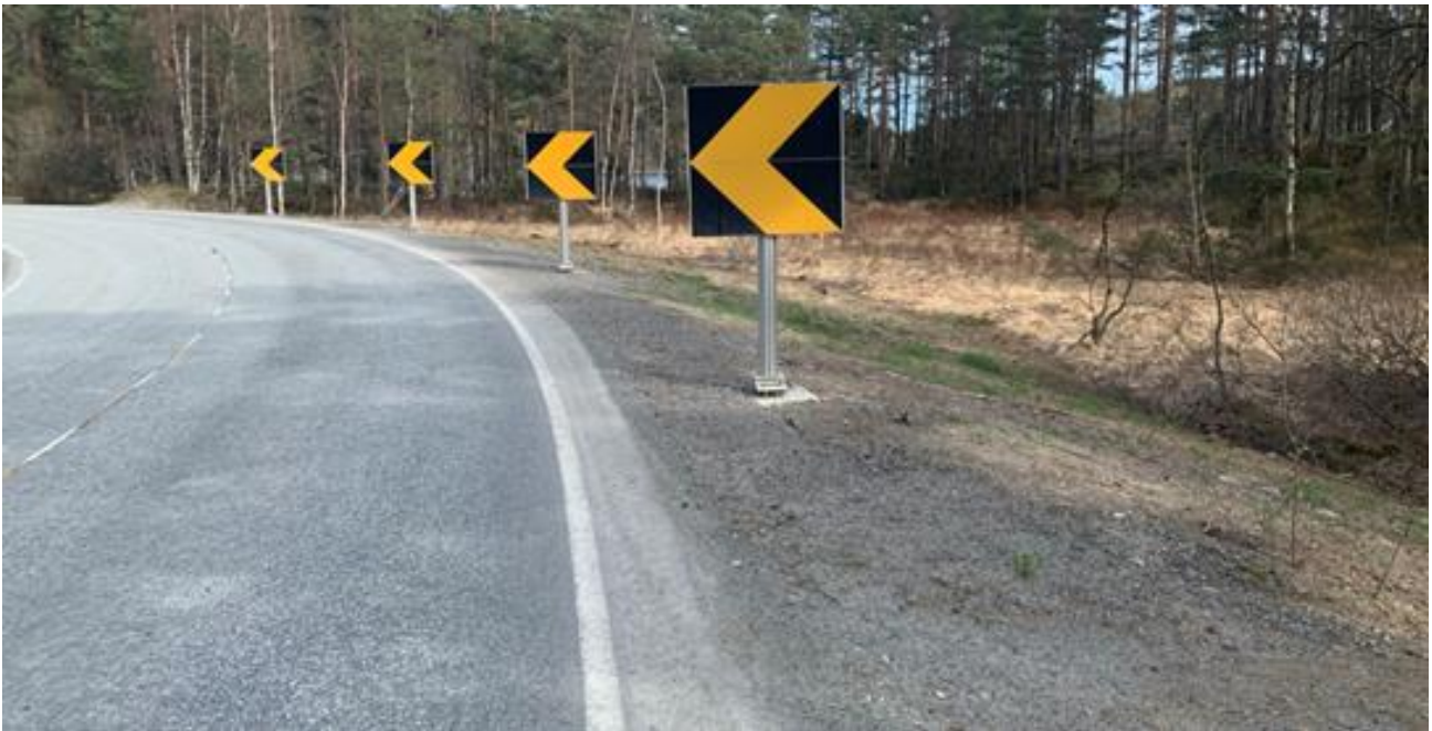
Figur 12: Retningsmarkering i sørgående kjørefelt. I nordgående (feltvognens) kjøreretning var det ikke retningsmarkering. Foto: Agder fylkeskommune
