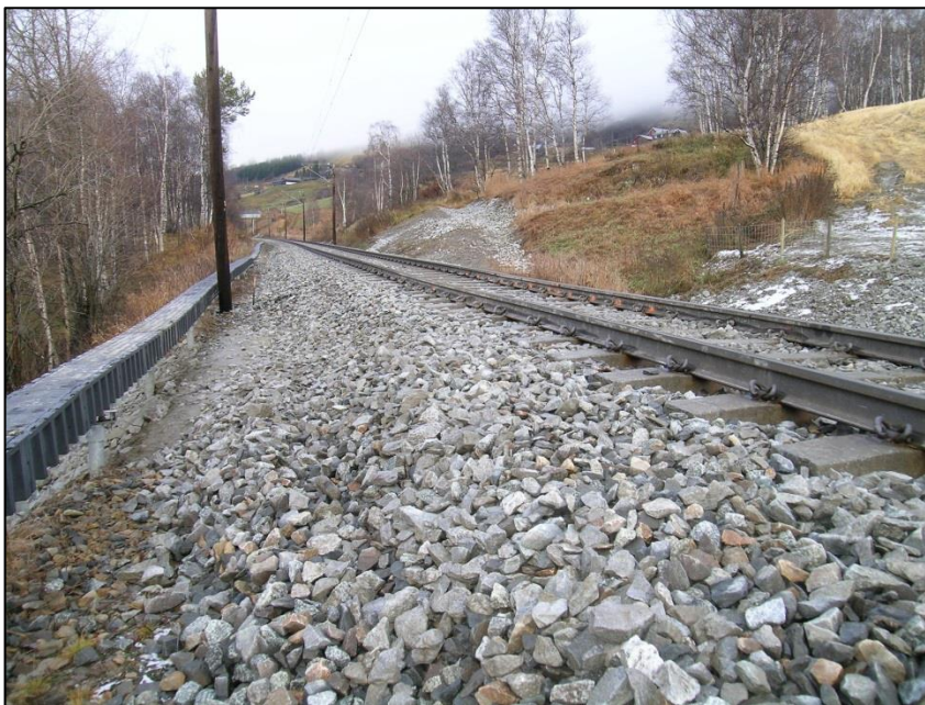
Figur 5: Punktet for setningen i sporet ved km. 333,816. Avsporingstedet er i høyre billedkant, ved km. 333,796. Foto: Jernbaneverket
