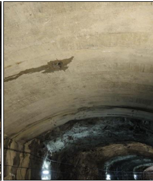
Figur 4: Hull i tunneltaket. Foto: SHT
