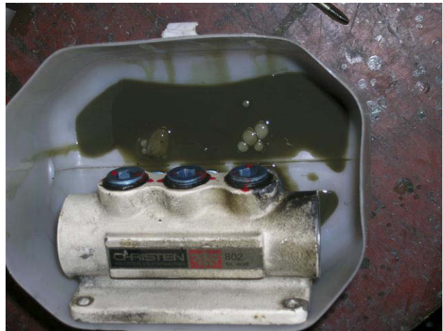
Figur 3: Is, vann og olje drenert fra oljeventil.
