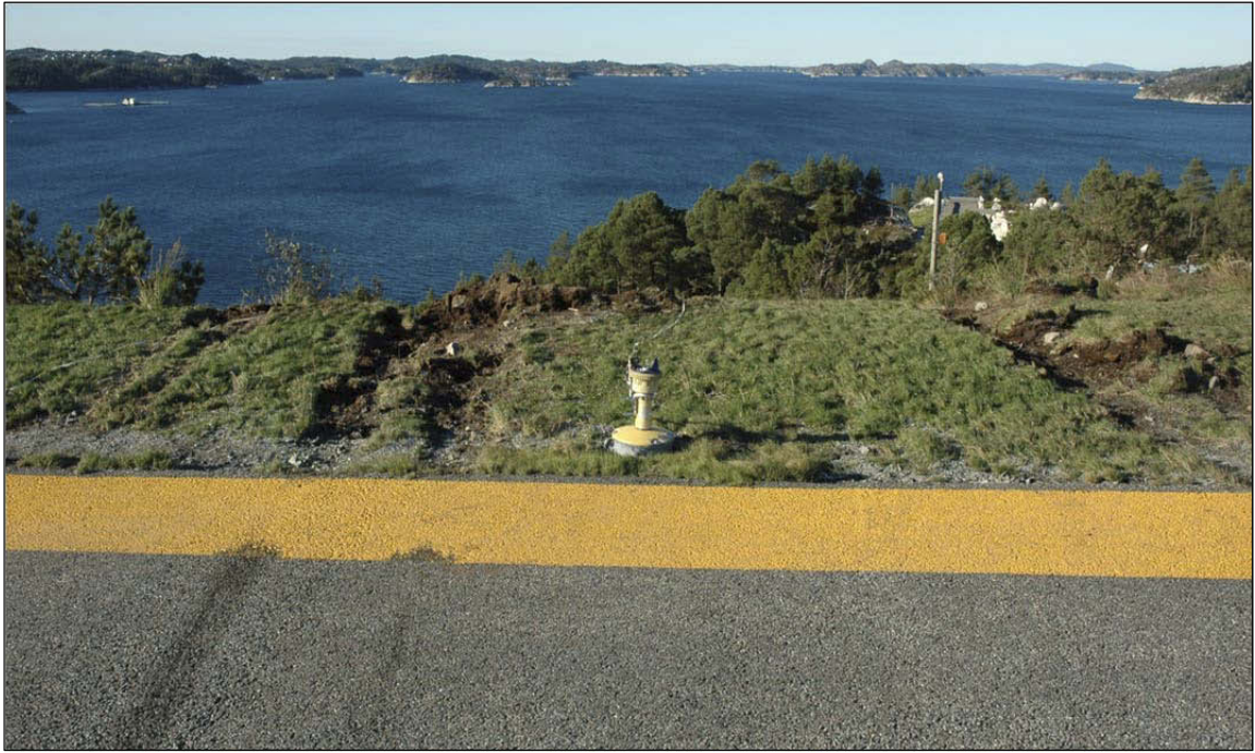
Figur 21: Rullebaneende med spor etter hjulene. Neseunderstell til venstre, deretter venstre hovedunderstell som har avsatt svarte striper i asfaltdekket og ytterst til høyre i billedkanten spor etter høyre hovedunderstell.
