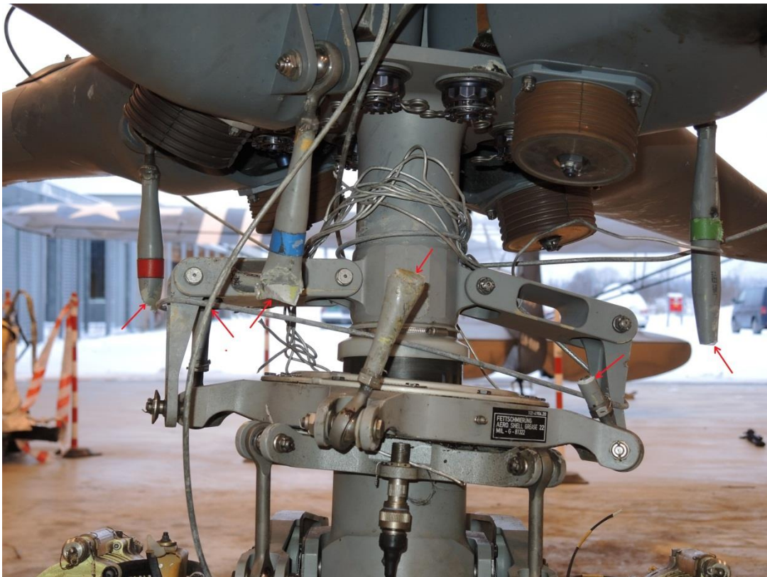
Figur 17: Rotorhode, rotormast, pitch-mekanisme og deler av ledningen. Kuttete pitchlinker er merket med røde piler. Foto: SHT
