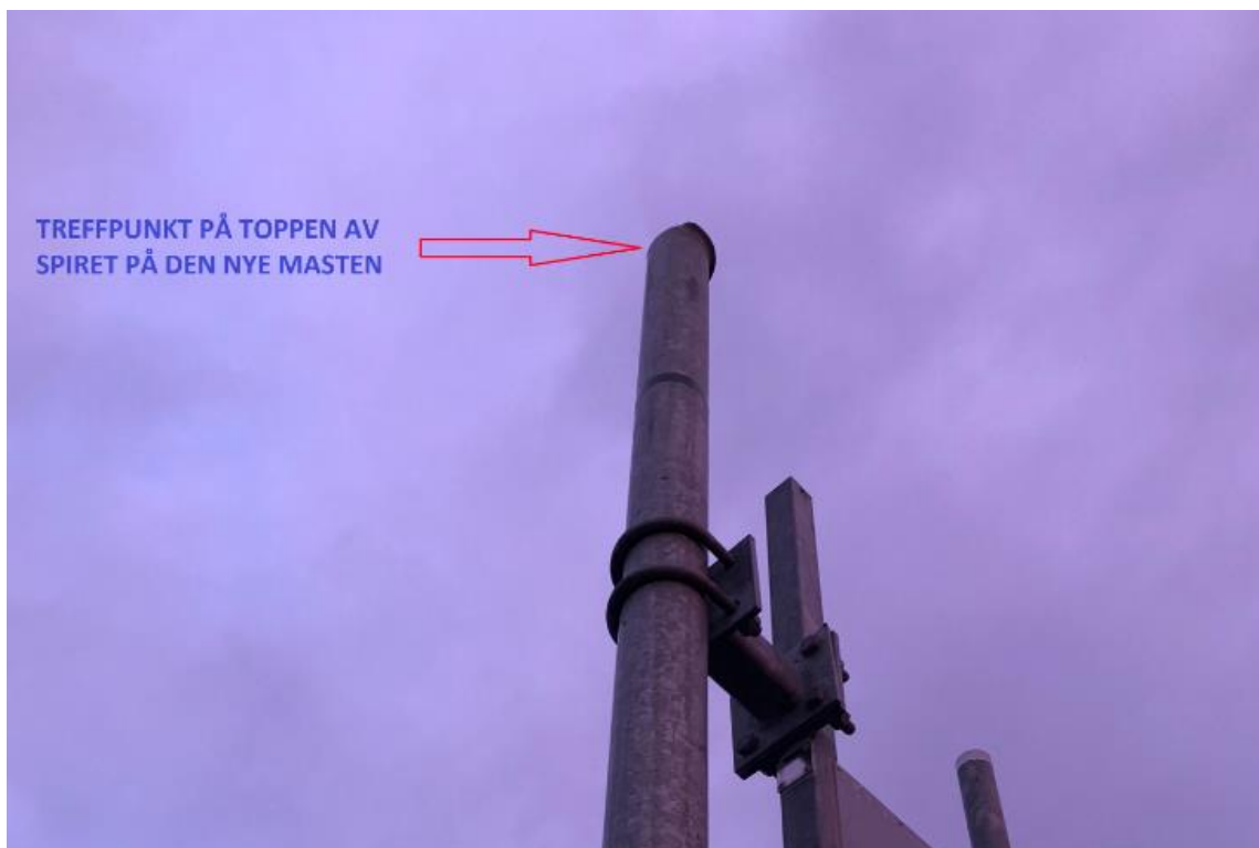
Figur 12: Skade på toppen av spiret. Foto: Heli-Team AS
