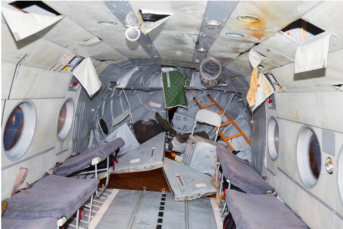
Figur 23: Deformerte lastedører. Bildet er tatt i retning bakover i kabinen mot lastedørene. Foto: Politiet
