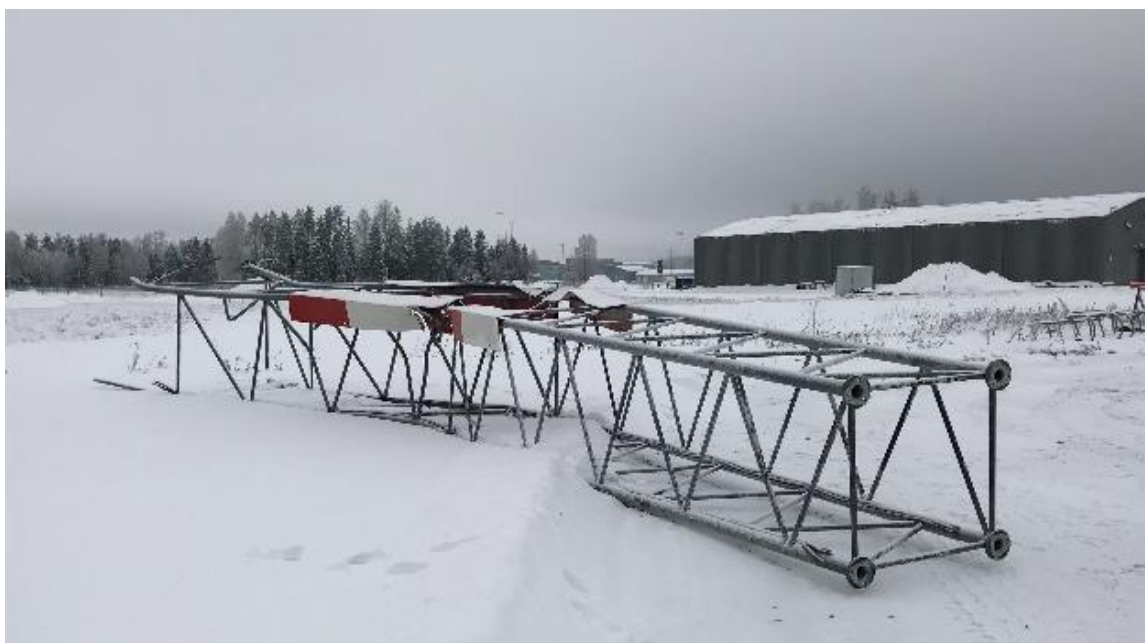
Figur 6: Skadene på lysmast (etter at den var tatt ned). Foto: SHT
