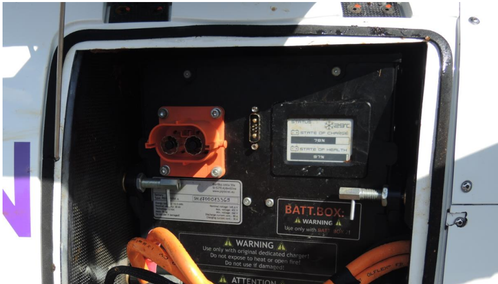
Figur 15: Fremre batteripakke viste en ladestatus på 78 % og en batteritilstand på 97 %. Disse avlesningene ble tatt etter at batteriboksen hadde vært under vann. Foto: Statens havarikommisjon
