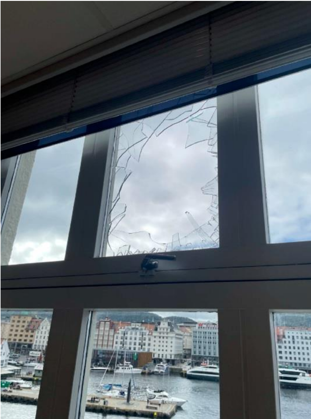
Figur 9: Skade på vinduet dronen fløy gjennom. Foto: Politiet/SHK
