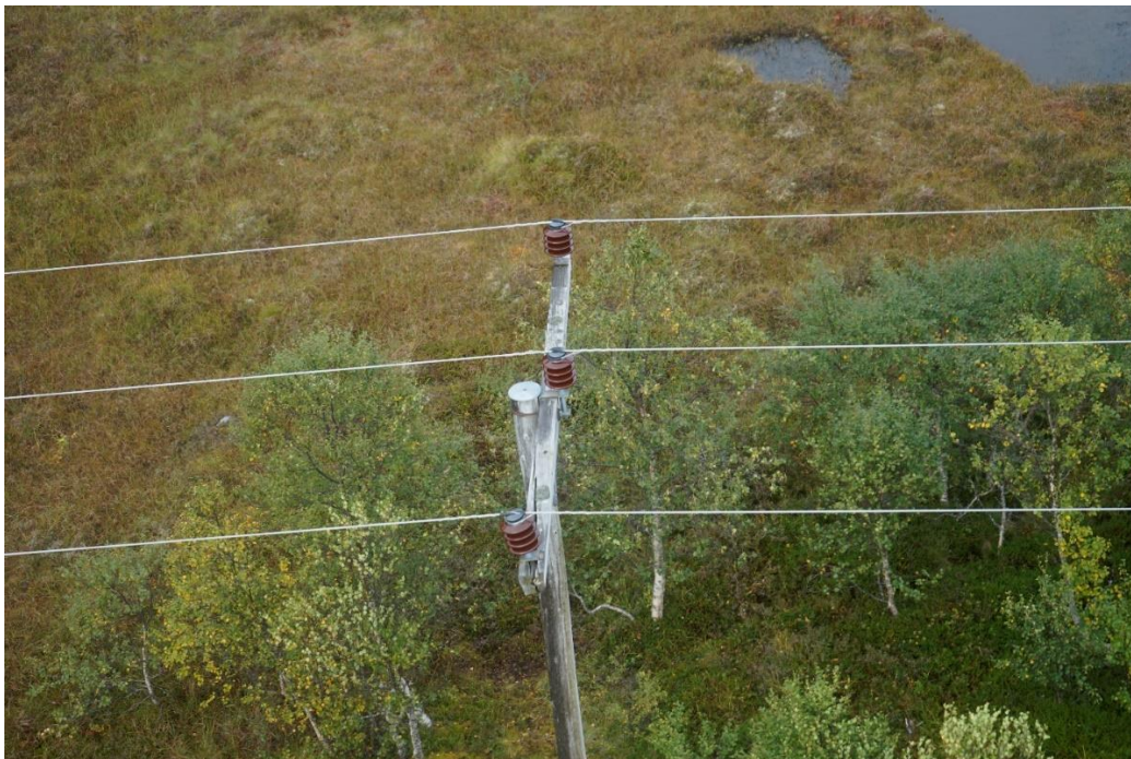
Figur 4: Et eksempel på en travers med skader som ble befart tidligere samme dag. Foto: Vesterålskraft Nett AS / SHK
