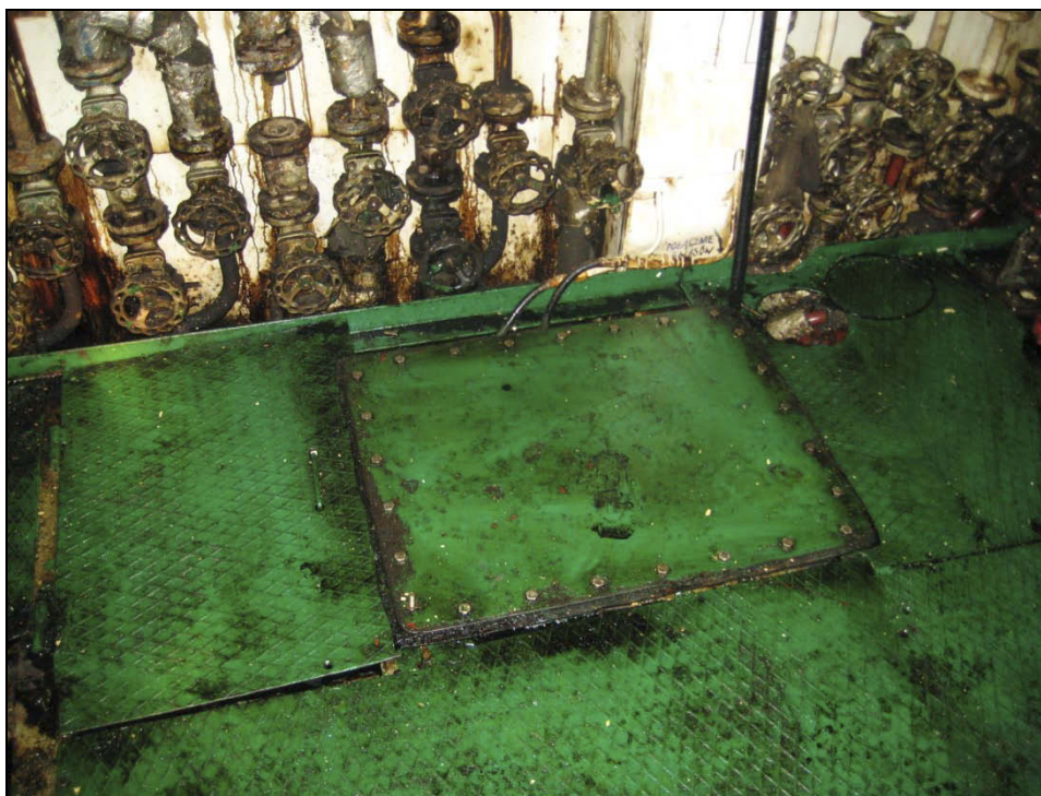
Figur 17: Mannlokk fra maskinrom til rørtrunk som går frem til baugthrustrerrom.
