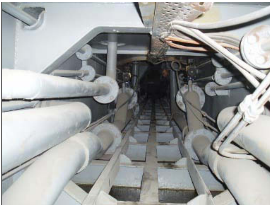
Figur 14: Bilde av rørtrunk.
