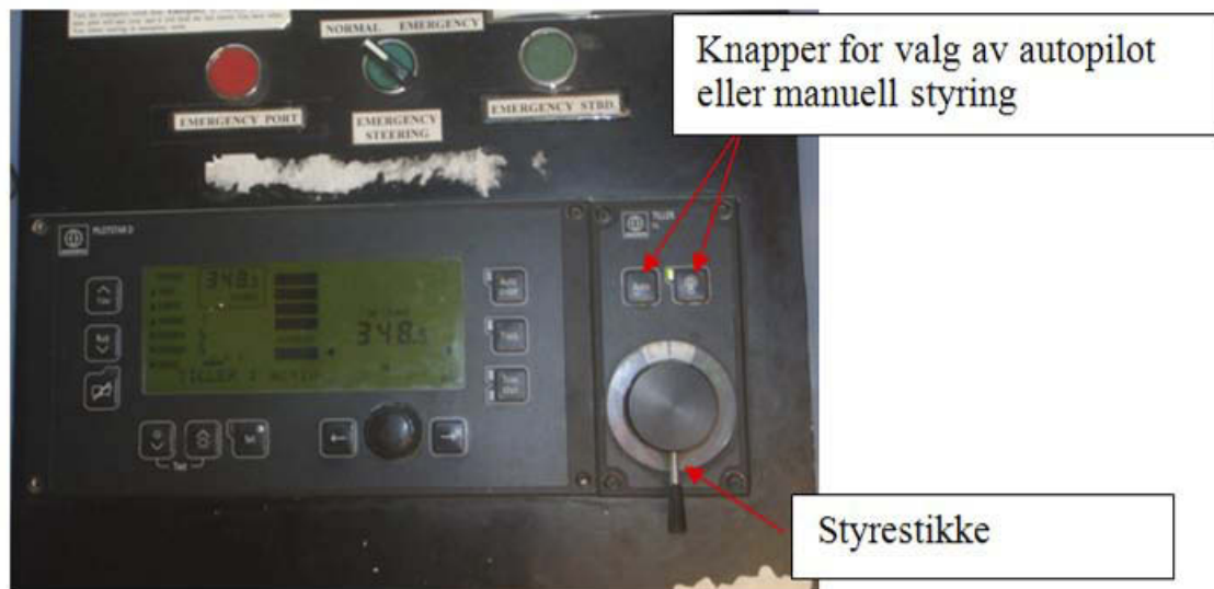
Figur 11: Autopilot plassert på den sentrale manøverpulten. Styrestikke sees til høyre i bildet. Bryter for å stille over fra normal til nødstyring og knapper for nødstyring sees rett over autopilotkonsollet.
