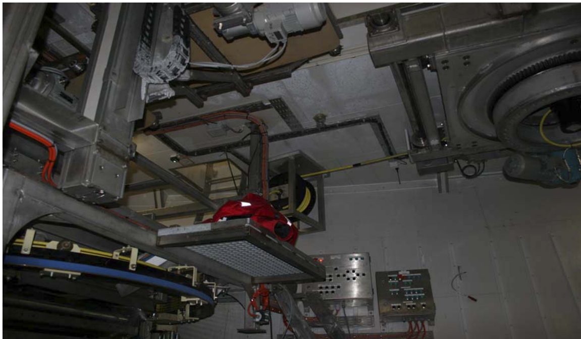
Figur 9: Reposet sett nedenfra - blokkheis stanset midtveis - styringspanel på skottet.
