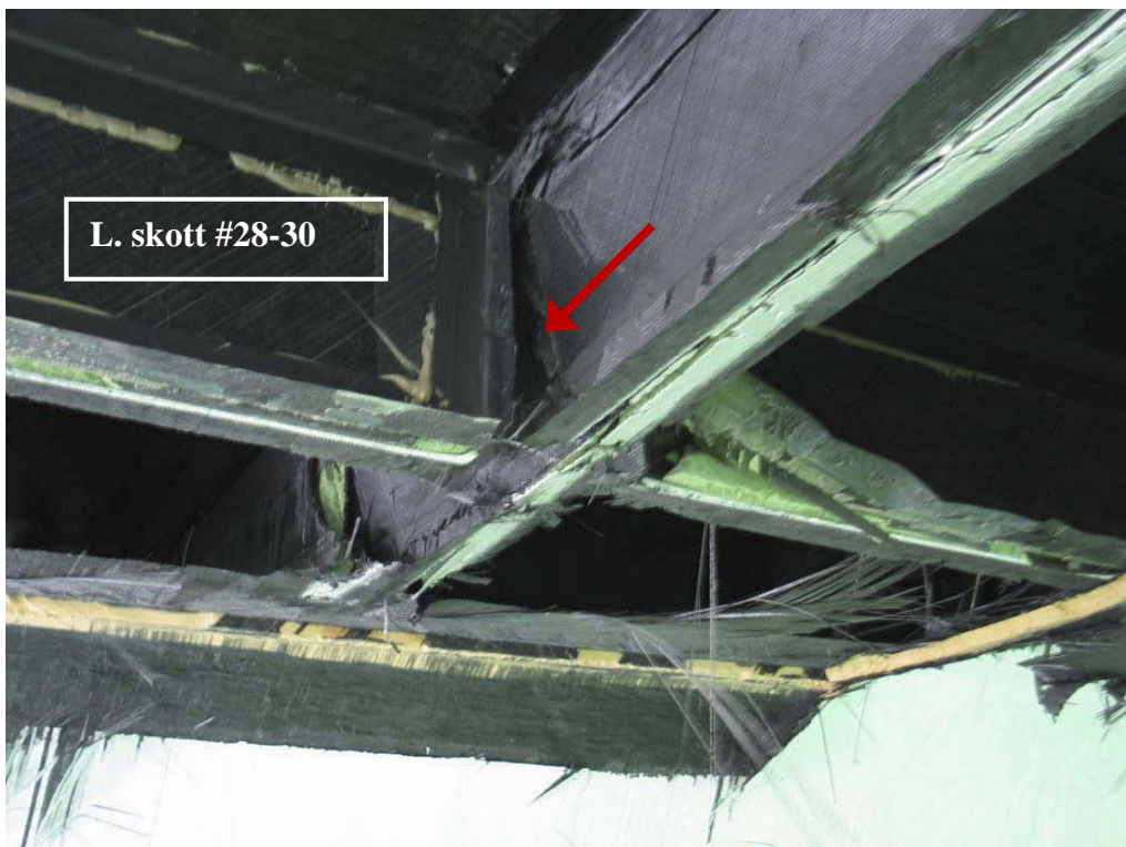
Figur 4.31 Langsgående skott (#28-30 SB) løsnet fra tverrgående skott #28
