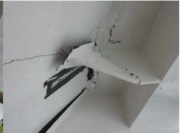
Figur 8: Avrevet og knekt bjelke fra skråpanel.
