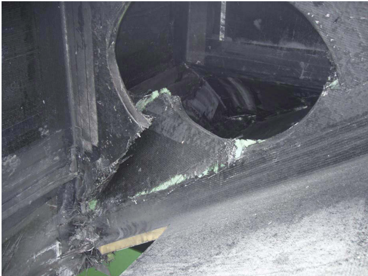
Figur 6.3 Bruddskade på støttestruktur.
