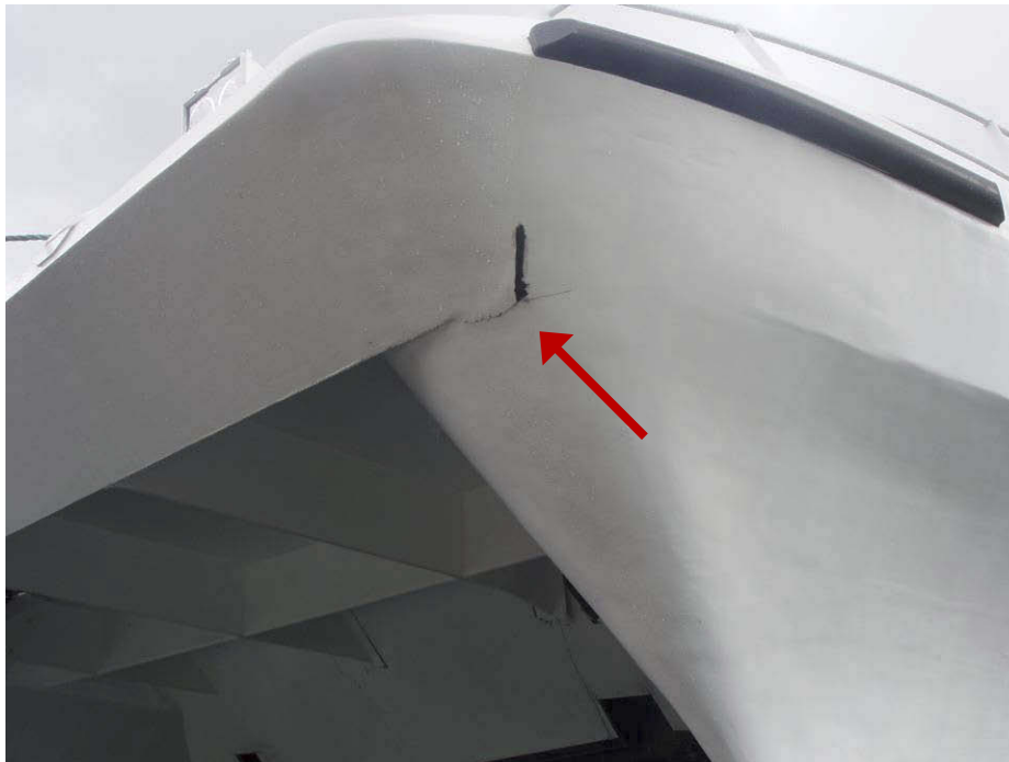
Figur 4.5 Sprekk nr. 1 i laminat BB side
