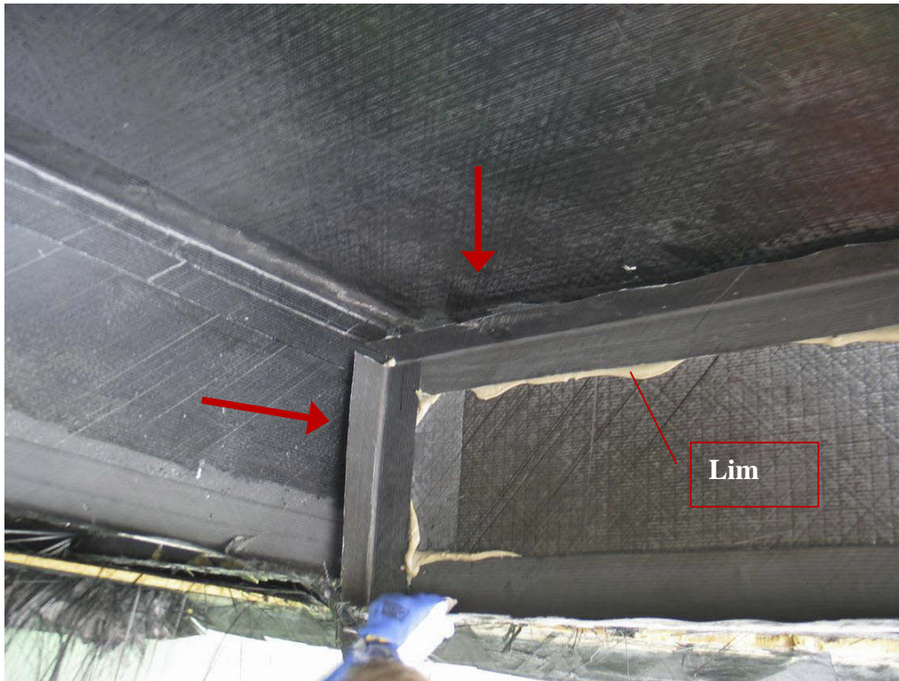
Figur 4.30 Langsgående skott (#28-30 BB) løsnet fra passasjerdekk og tverrgående skott #28 akter. Skott limt mot CL og laminert på utside. Laminering (yttersiden) mot våtdekk løsnet fra skott
