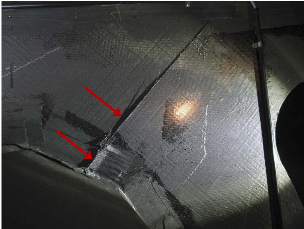
Figur 4.27 (1) 45° kompresjonsbrudd i laminat på bunnstokk BB. Overflater er forskjøvet og overlapper 5-7mm
