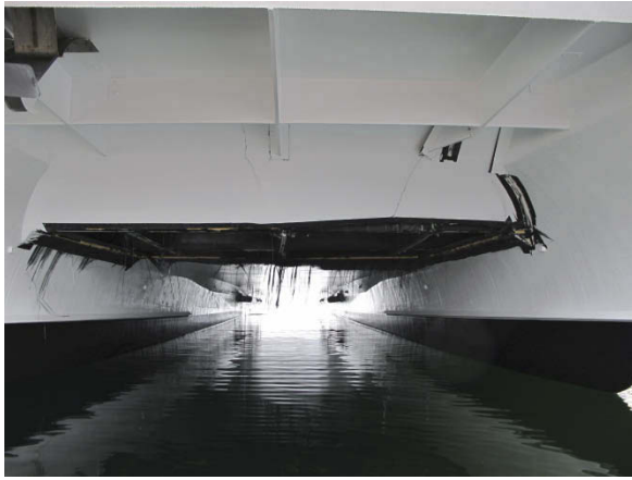
Figur 5: Skråpanelet i forre del av våtdekket er trykket inn.
