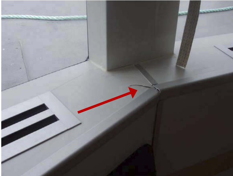
Figur 4.11 Sprekk i vindusforing frontskott (BB)
