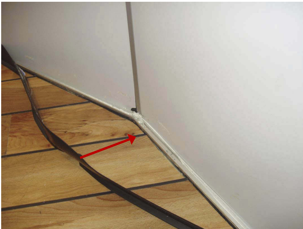
Figur 4.12 Sprekk mellom belegg på frontskott og dekkbelegg BB
