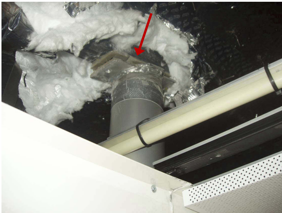
Figur 4.10 Søyeløst fra dekkbærer BB. Antydning til det samme SB
