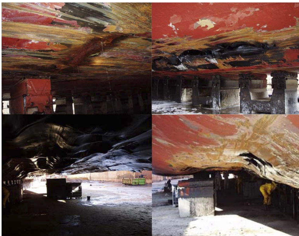
Figur 8: Godafoss ble slept til verft i Odense, Danmark hvor DNV foretok klaseselskapets survey i perioden 5. mars til 14. april 2011. Alle foto er tatt av DNV under reparasjonsoppholdet.
