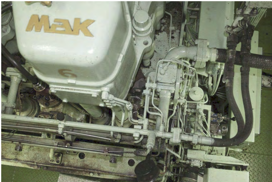
Foto 1 Indikatorkran 6 sett ovenfra.
