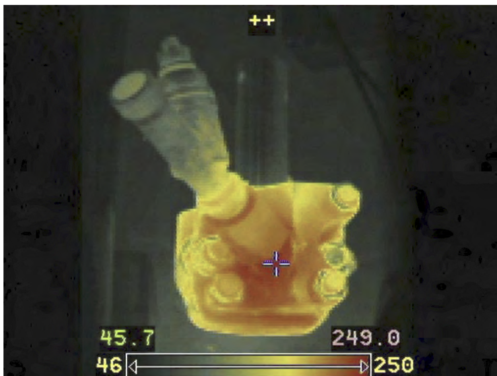
Figur 9 IR-bilde av indikatorkran 5
