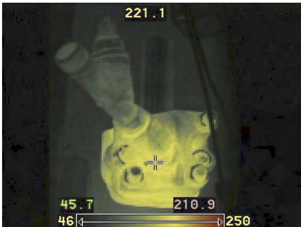
Figur 2 IR-bilde av indikatorkran 1
