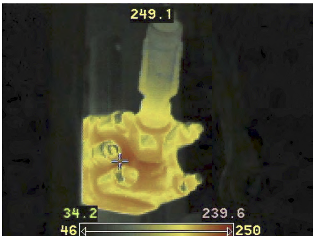
Figur 12 IR-bilde av indikatorkran 6
