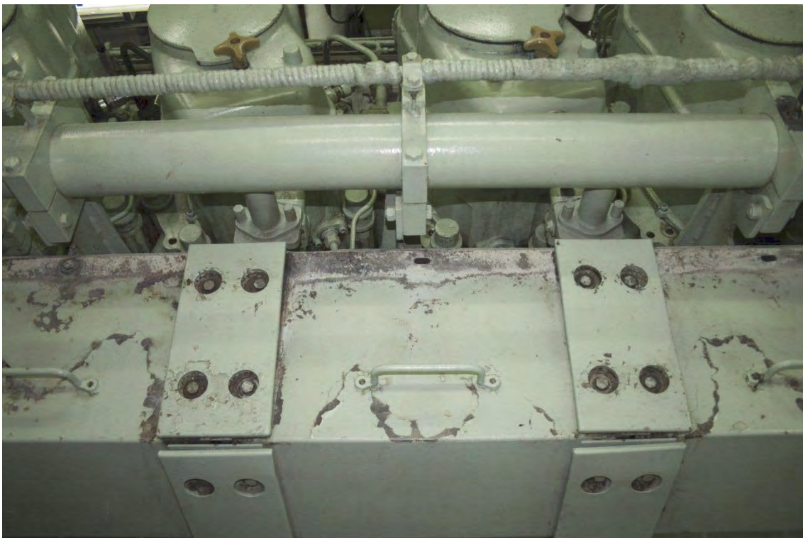
Foto 4 Deksel rundt eksosmanifold. Lakken ser ut til å være varmepåvirket.
