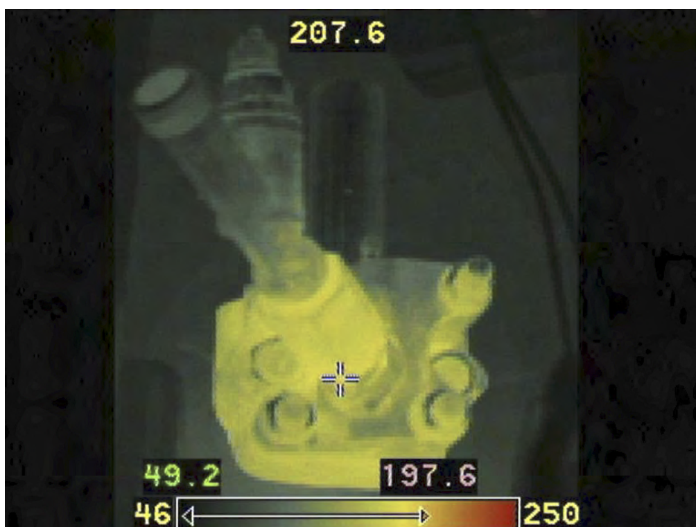
Figur 4 IR-bilde av indikatorkran 2
