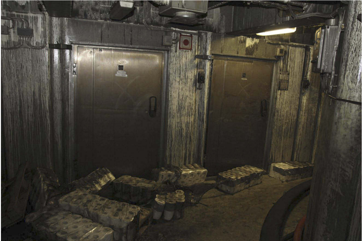
Figur 8: Utenfor kaldproviantrom mellom trappesjakt midtskips og hovedmaskinrom på dekk 1. Temperaturen har vært så høy at plasten rundt toalettrullene har smeltet. Foto: SINTEF NBL
