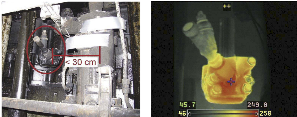
Figur 23: Bildet til venstre viser indikatorkranen mellom sylinder nr. 4 og sylinder nr. 5 på styrbord hovedmotor samt avstanden til drivstoffpumpe nr. 5 (rørene er fjernet). Indikatorkranen ble funnet uisolert. Bildet til høyre viser termografi av tilsvarende indikatorkran om bord i Richard With. Foto venstre bilde: SHT. Foto høyre bilde: SINTEF NBL
