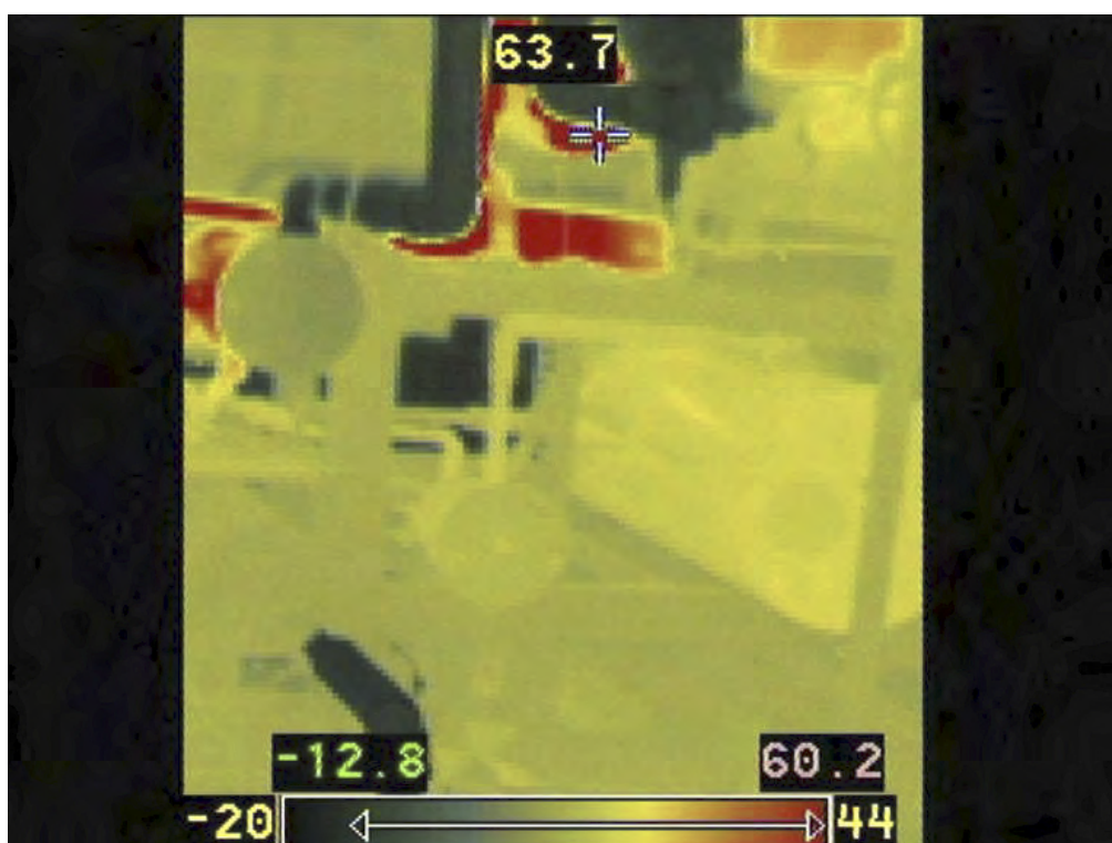
Figur 16 IR-bilde av kjølekompressor
