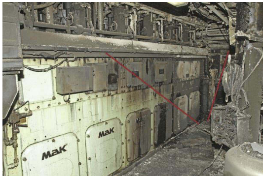
Figur 42: Styrbord side av styrbord hovedmotor sett forover på tanktoppriva. Brannen har satt spor fra dørken og oppover i V-form (brannvifte). Foto: Politiet
