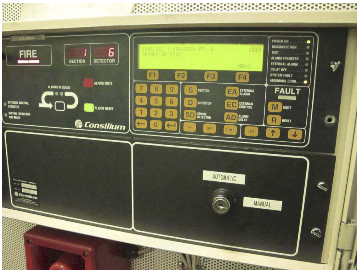
Figur 29: Bildet viser panelet for punktslukkeanlegget. Ved havarikommisjonens undersøkelser om bord, ble panelet, som er plassert i maskinkontrollrommet, observert i manuell mode. Det sto ingen nøkkel i bryteren som skifter mellom manuell og automatisk slukking. Foto: SHT
