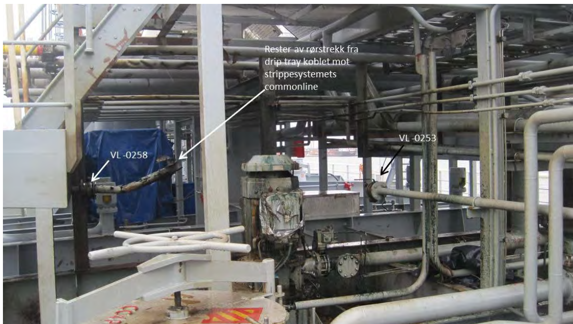
Figur 21: Figuren illustrerer restene av rørstrekket fra drip-trayet på babord side mot dreneringslinen etter eksplosjonen, jfr. figur 20. Foto: SHT
