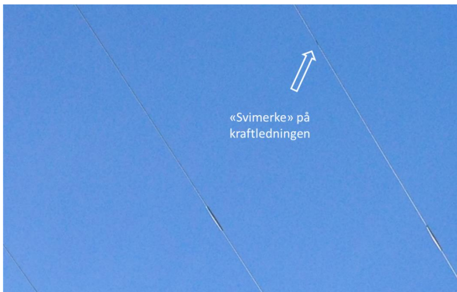
Figur 4: De tre høyspentledningene over Fyrsundet. På ledningen oppe til høyre i bildet kan det observeres et svimerke etter den sannsynlige berøringen med fiskestanga. To av ledningene på bildet har en "sprenghylse" etter tidligere reparasjoner. Foto: Lofotkraft
